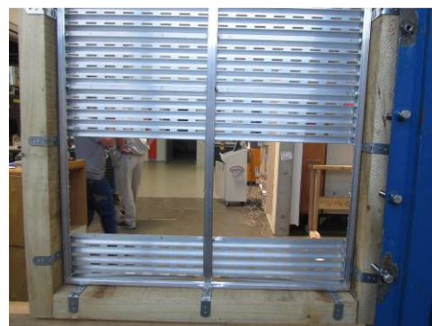
Bild 6 Schäden aus der manuellen Prüfung der Anbindung des Lamellenpakets
